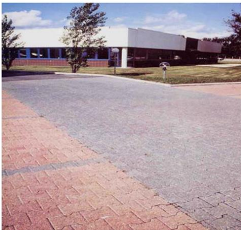
Reservorio en Parqueo y adoquines drenantes Source CETE du Sud-Ouest
